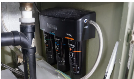
Het waterfilter onder de kraan in Eric Engles huis.
